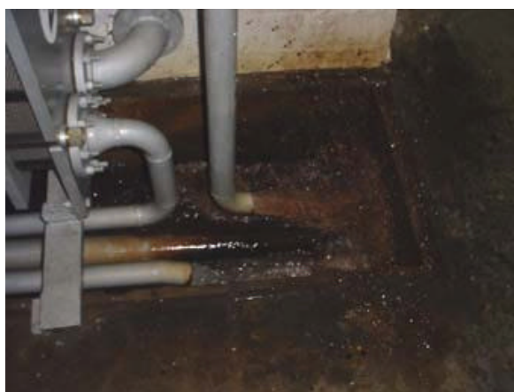
Figura 3: Limpeza mecânica do trocador de calor – UHE GPS
